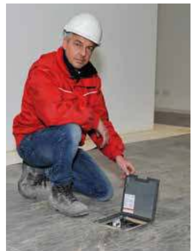
Contactpunten voor elektro en data zijn in de vloer aangebracht.
