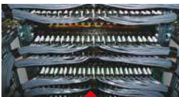
DATA-, TELECOM, GLASVEZEL
